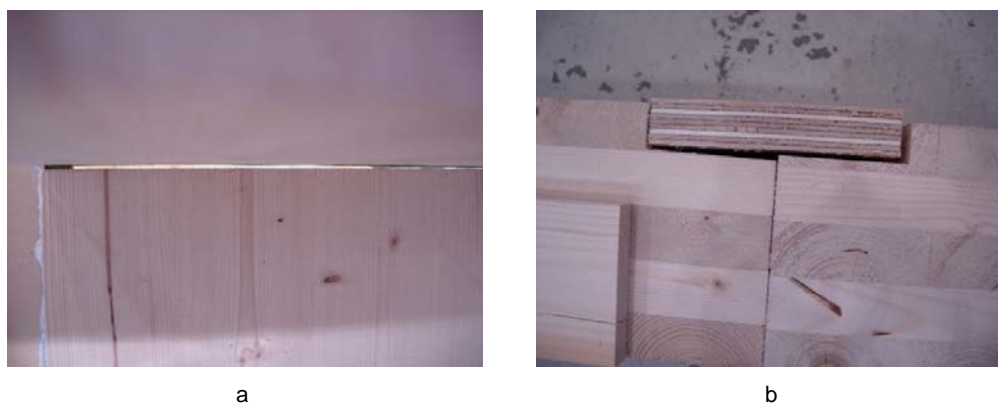
Figur 8.1 Eksempler på unøyaktigheter i massivtreelementene. Høydeforskjell på veggelementene gir glippe mellom vegg- og gulvelementene (a). Unøyaktig utfresingen i skjøten mellom gulvelementene gjør at dekkbordet i skjøten gir dårlig lufttetting (b).
