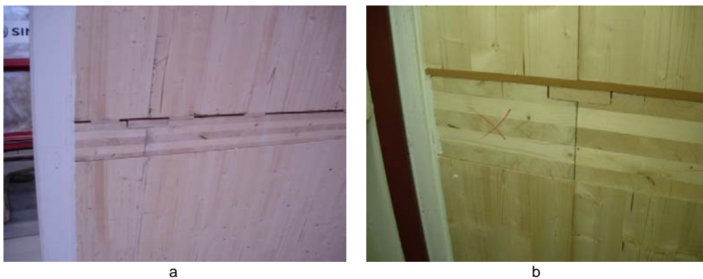
Fig 3.3 Prøvefeltet med massivtre uten kantliming og veggelementer lagt an på klosser av kryssfiner oppå gulvelementer (a). Prøvefeltet med kantlimt massivtre og veggelementer lagt an på sylomérlist (b).
