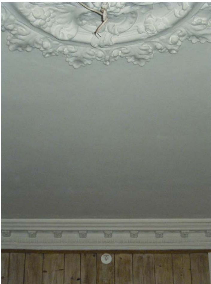
Bilde 9.3 a: Veggspinkler i stue
