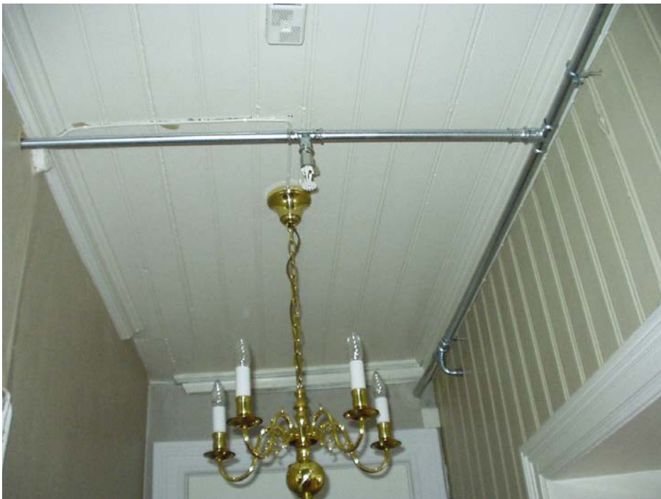
Bilde 7.3.3 b: Åpen rørføring i entré.
