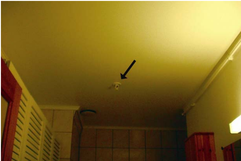
Bilde 9.3 c: Taksprinkler i bad
