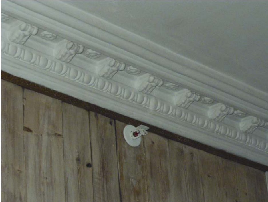
Bilde 7.3.3 a: Veggspinkler i stue
